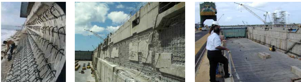
Figur 12 Beständigheten hos GFRP är överlägsen stål i marina miljöer utsatta för havsvatten. Vänster: Skyddsmur i Florida, USA, i mitten och höger: Rehabilitering av en torrdoca i Pearl Harbor, Hawaii, med GFRP armering ( http://www.hughesbros.com/ )
